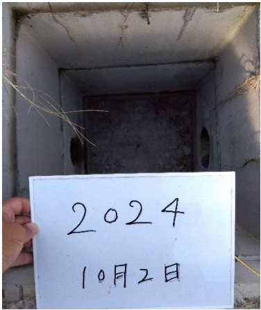
最終集水桝（場内）
