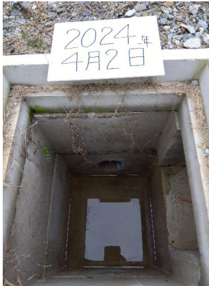
最終集水桝（場内）
