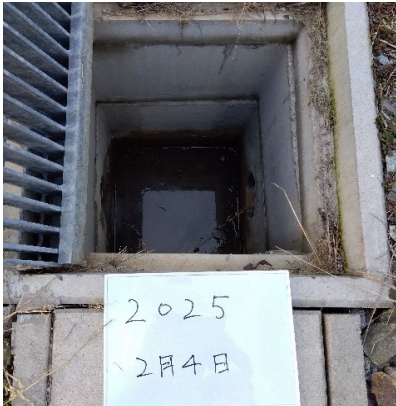
最終集水桝（場内）
