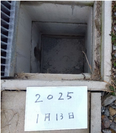
最終集水桝（場内）
