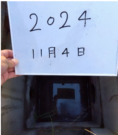
最終集水桝（場内）
