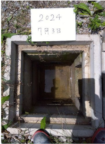
最終集水桝（場内）
